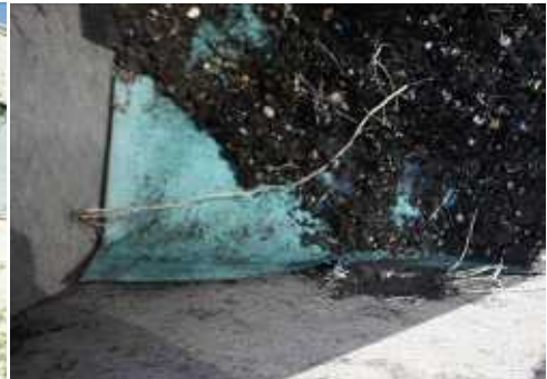
ボードには根が張り付いているが、 シートには張り付いていない
