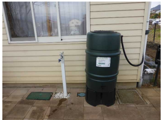
・立柱散水栓と雨水タンク
