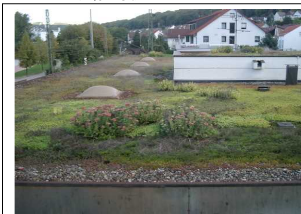
・駅舎の屋上緑化:立上り際の雨水を底面に浸透させるため、砂利が敷設されている事例。
