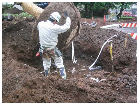
・抵抗板地下支柱
