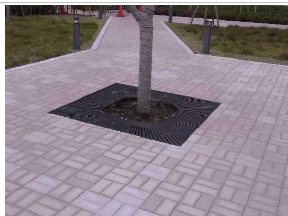
・改修前の水はけが悪く根腐れを起こし樹木が枯れたツリーサークルの緑地
