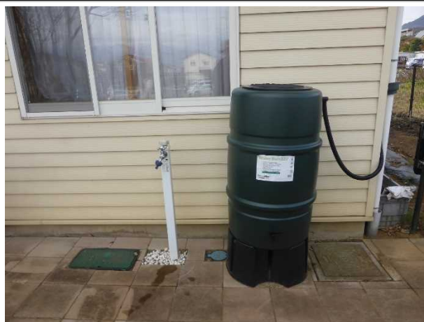
・立柱散水栓と雨水タンク
